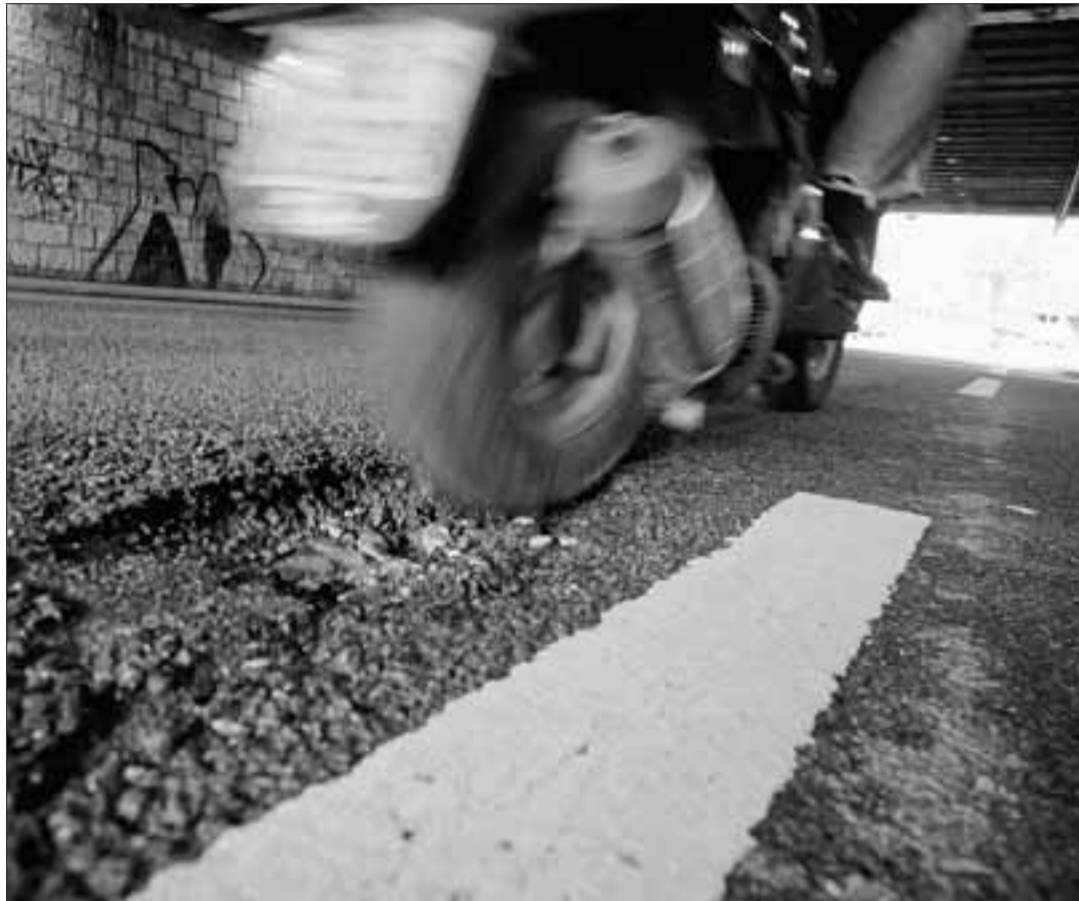
TÉMÉRAIRE Passer sur un nid-de-poule peut s'avérer dangereux pour les deux-roues (ici le sous-voies de la rue d'Aarberg) (OLIVIER GRESSET)
